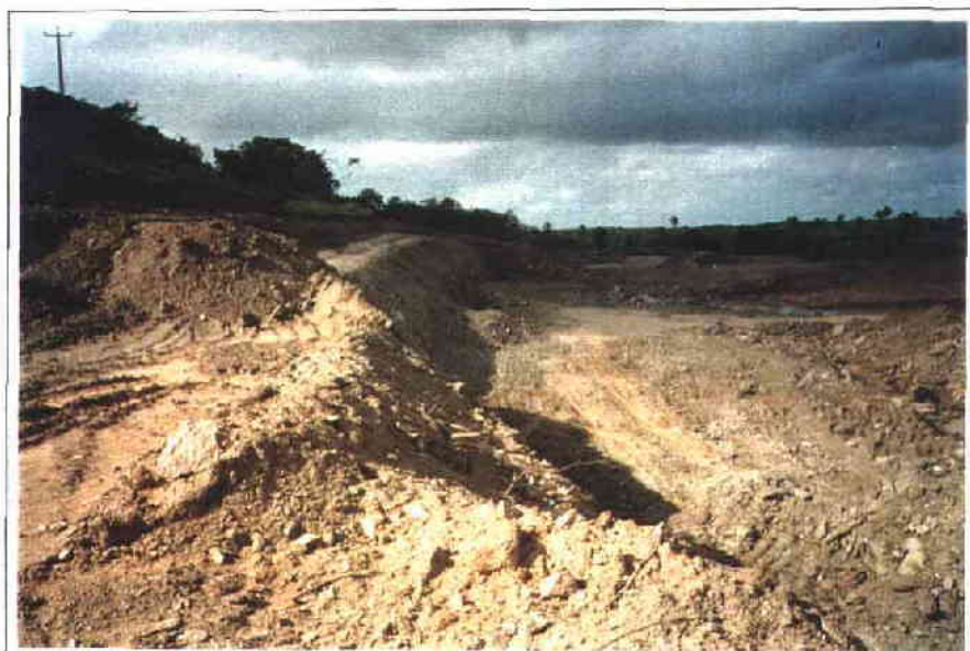
FOTO 17/32 - Obra de construção do açude Sítios Novos, fonte hídrica do sistema adutor ora em estudo. Vista parcial da ombreira direita do barramento.
